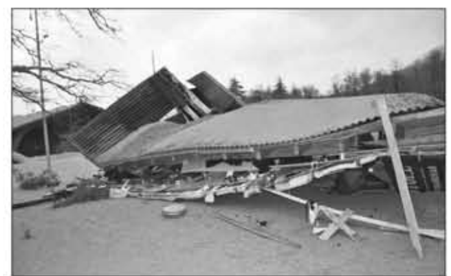
Ejemplo de colapso de un techo por sobrecarga de ceniza y nieve, en Paso Cardenal Samoré.
